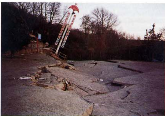
Fig. 16 - Scorrimento rotazionale in riporti (loc. Picco S. Angelo - Sorrento).
