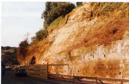
Fig. 17 - Crollo in depositi detritico-piroclastici (Castellammare di Stabia).
