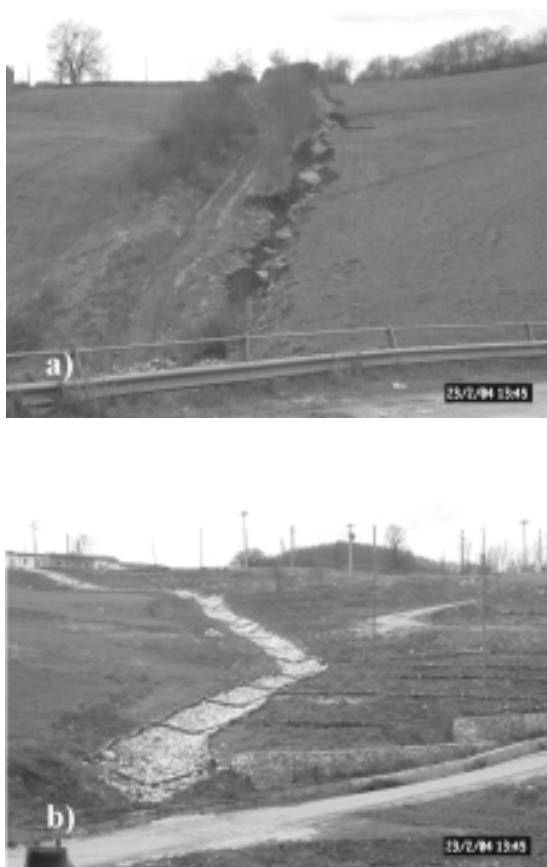
Figura 9. Circello (BN), loc. Masseria del Principe. a) Azione erosiva delle acque superficiali prima dell'intervento. b) Intervento in corso d'opera: canalette drenanti in pietrame, finalizzate alla regimentazione delle acque superficiali, e palizzate.
