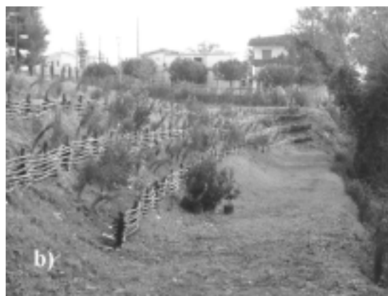
Figura 5. Parco Urbano dei Camaldoli (Napoli). a) Frana da scorrimento traslativo (gennaio '97). b) Graticciate.
