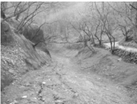
Figura 7. Casola di Napoli, versante settentrionale di M. Muto. Rinverdimento (mediante idrosemina) dell'area dopo circa due mesi dalla conclusione dell'intervento.
