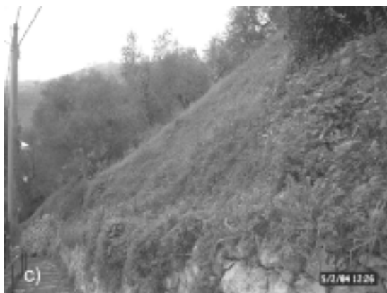
Figura 8. Vico Equense (NA), loc. Pacognano. a) Area di studio prima degli interventi. b) Rivestimento realizzato con reti esagonali a doppia torsione e biostuoia rinverditata in aderenza alla scarpata, montate con l'ausilio di chiodature. c) Rivestimento: biostuoie antierosive in fibra di paglia di cocco, allestite con l'ausilio di rete esagonale a doppia torsione. Inerbimento tramite idrosemina.
