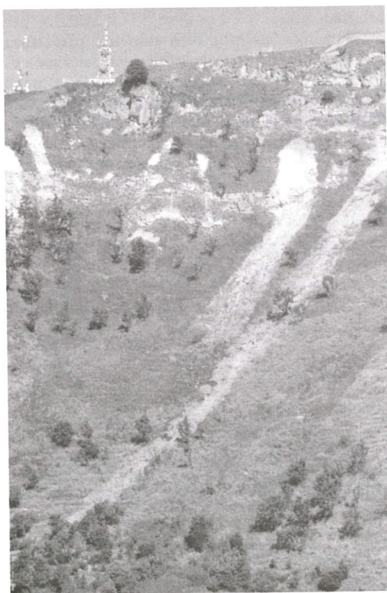
Figura 13. Frana da scorrimento-crollo-colata verificatasi nel gennaio 1997 lungo il versante meridionale della Collina dei Camaldoli
